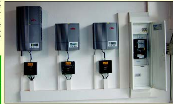
Drei Gleichrichter verwandeln vor der Einspeisung ins Netz den Sonnenstrom in Wechselstrom. Außerdem gibt eine Anzeige im Schaltschrank Auskunft über die erzielten Erträge.
