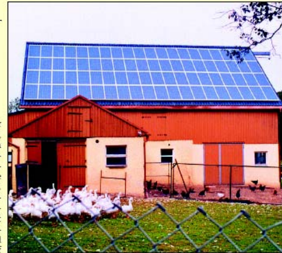
102 Quadratmeter groß ist die Anlage auf dem Scheunendach, die für Mathias Rudolph Sonnenenergie in elektrischen Strom umwandelt.
